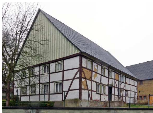
Sanierungsbedürftiges historisches Fachwerkgebäude
