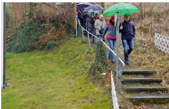
Sanierungsbedürftige innerörtliche Fußwegeverbindung im Bereich am Steinberg
